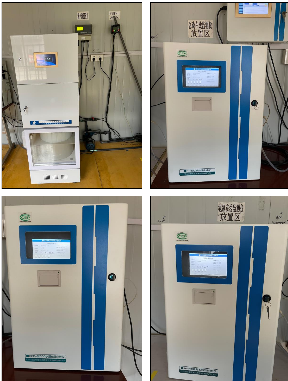
图 4.2-2 废水在线监测装置
